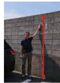
▲小学校の基準超えの危険なブロック塀。長年放置されていたことが中山の調査で判明
